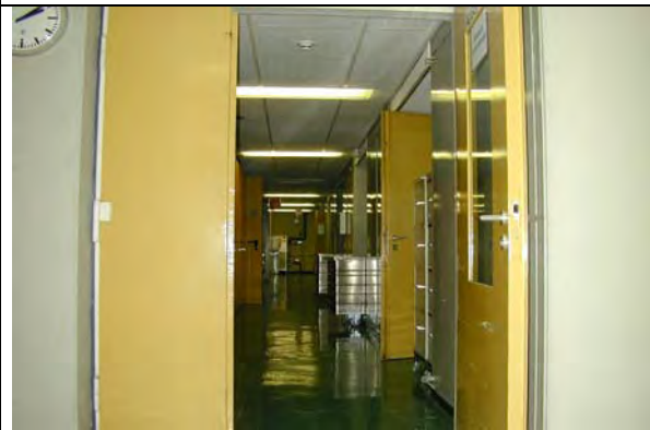
Bild 3-20: Verkehrswege vor der Sanierung
