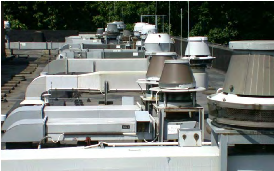
Bild 2–3: Dezentrale Abluftführung im Laborgebäude Phytosphäre
