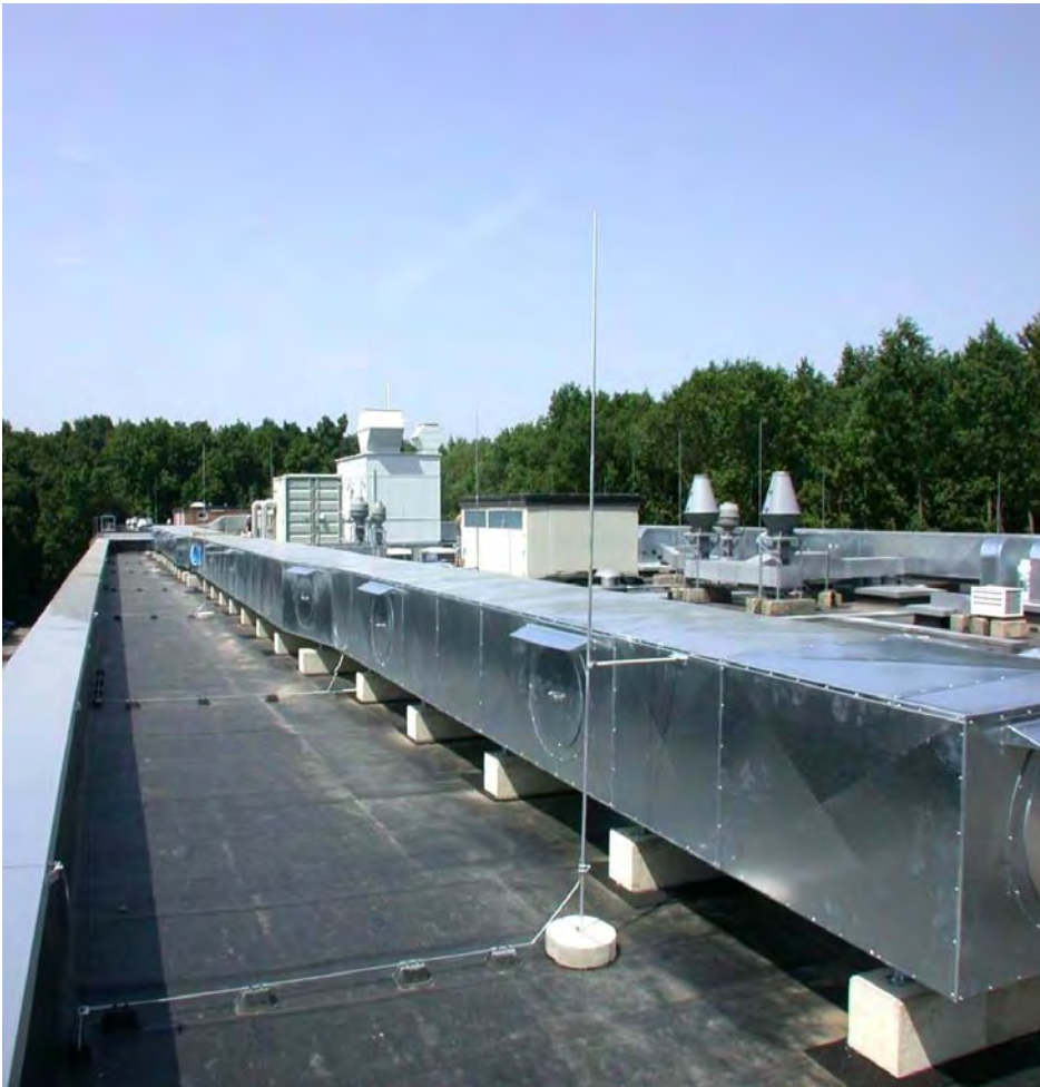
Bild 3–14: Abluftsammelkanal auf dem Dach
