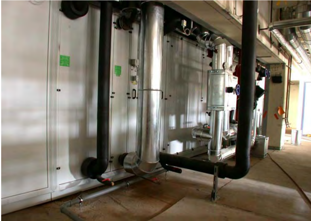
Bild 3–13: Zuluft-Zentralgerät mit Wärmerückgewinnung im Erdgeschoss
