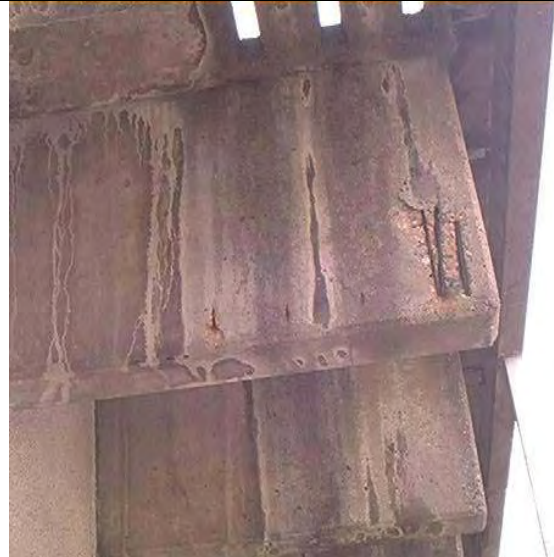
Bild 3-25: Betonabplatzungen vor der Sanierung:
