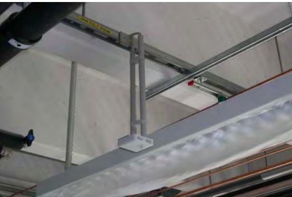
Bild 3–46: Anwesenheitssensor zur Steuerung der Beleuchtung
