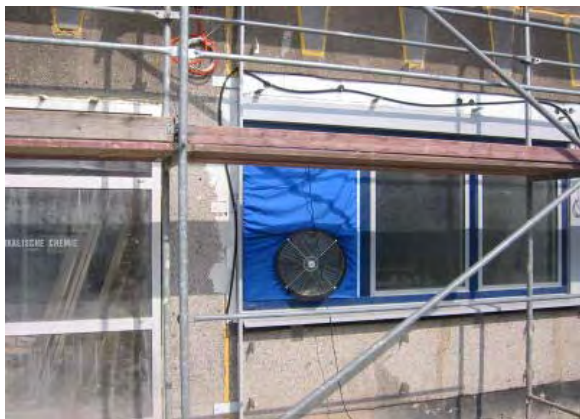
Bild 3-61: Blower-Door im Fensterrahmen
