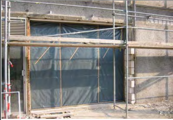
Bild 3-57: Zuluftöffnung an der Giebelseite
