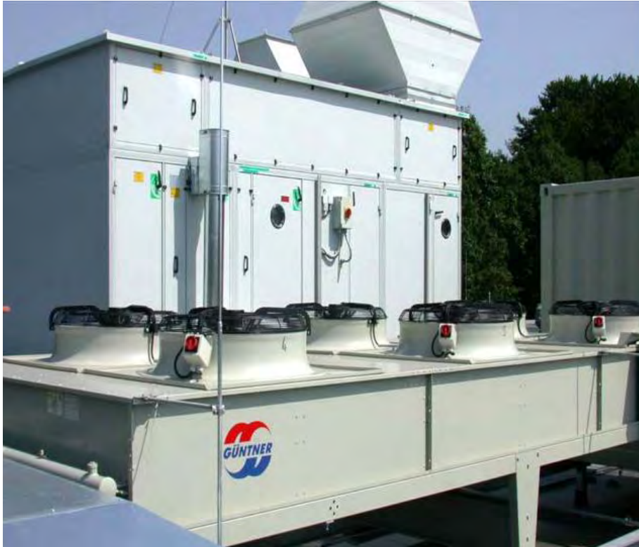
Bild 3–15: Freikühler (Vordergrund) und Abluftgerät mit Wärmerückgewinnung
