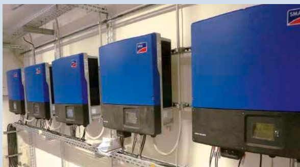
Abb. 93: Elektrische Wechselrichter mit Leistungsanzeige Foto: Fraunhofer IBP
