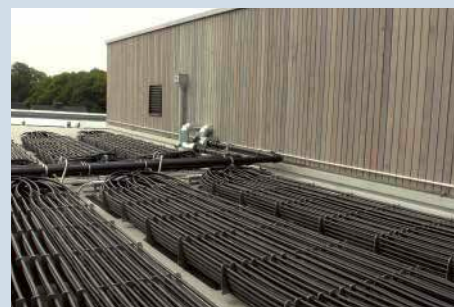
Abb. 36: Die Solarabsorberanlage auf dem Dach Foto: COPLAN AG
