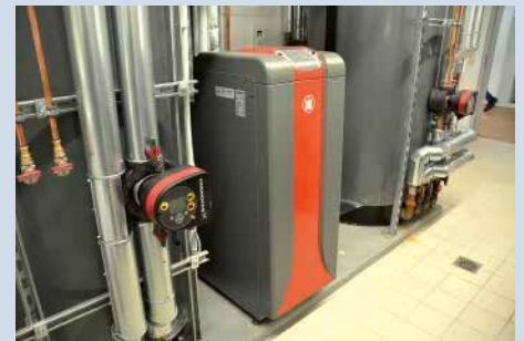
Abb. 72: Wärmepumpe und Schichtenspeicher Foto: Haase & Bey Architekten
