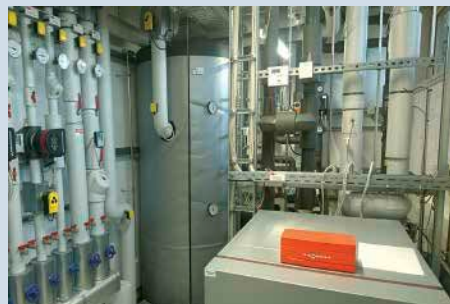
Abb. 59: Die Haustechnikzentrale Foto: Stadt Feuchtwangen
