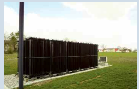
Abb. 60: Der Solar-Luftabsorberblock Foto: Stadt Feuchtwangen
