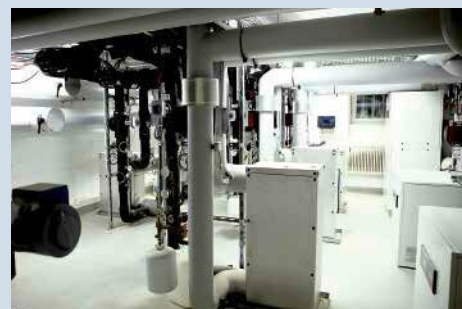
Abb. 25: Blick in die Technikzentrale Foto: Gymnasium Neutraubling
