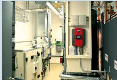
Abb. 71: Der Technikraum Foto: Haase & Bey Architekten
