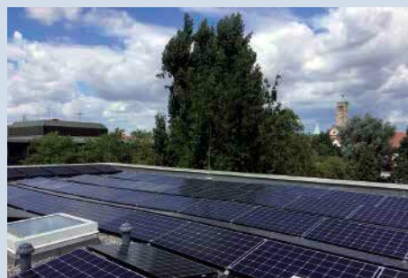
Abb. 12: Die Photovoltaik-Anlage Foto: Rhein-Neckar-Kreis
