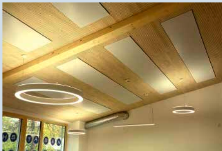
Abb.70: Integrierte Deckenheizung, LED-Leuchten Foto: Haase & Bey Architekten
