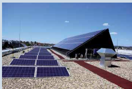
Abb. 23: PV-Anlage auf dem Dach des Neubaus Foto: Gymnasium Neutraubling
