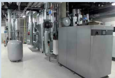
Abb. 35: Die Wärmepumpe im Technikraum Foto: COPLAN AG
