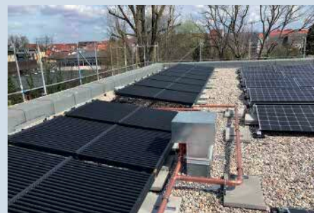
Abb. 13: Die Solarthermie-Anlage Foto: Ingenieurbüro Willhaug
