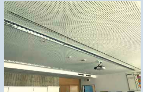
Abb. 48: Zuluft-Schlitzschienen in den Decken Foto: Stadt Kaufbeuren
