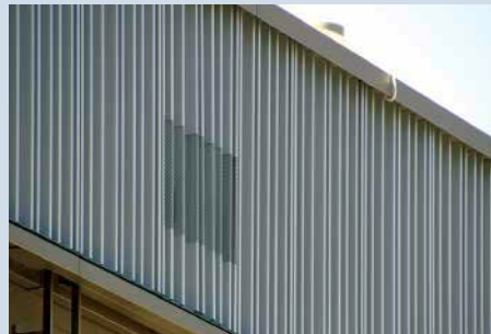
Abb. 47: Fassadendetail der Luftein-/auslässe Foto: Stadt Kaufbeuren
