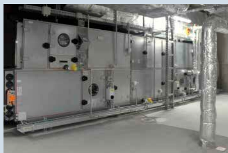
Abb. 34: Die zentrale Lüftungsanlage Foto: COPLAN AG
