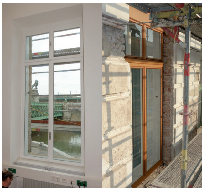
Abb. 4: 1. Arbeitsschritt: Erneuerung der Innenfensterebene (links), 2. Arbeitsschritt Erneuerung der Aussenfensterebene (rechts), Fotos ©: Wiener-Komfort-Fenster
