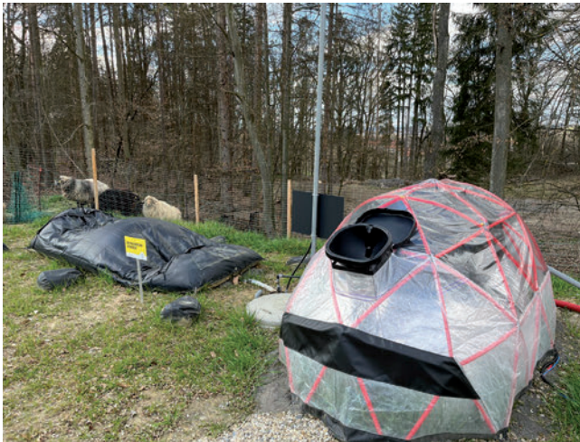
Biogasanlage mit Gassack
