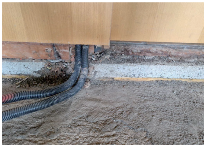
Bei der Sanierung sollten auch kleine Mengen behandelten Holzes nicht übersehen werden, wie bspw. hier unter einer Türschwelle.
