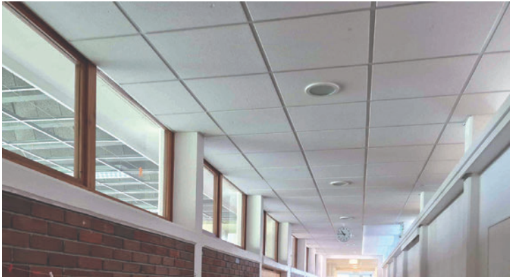
Poröse Deckenelemente einer abgehängten Decke als mögliche Sekundärquellen für Chloranisole.
