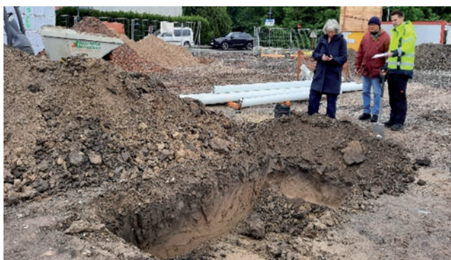
Abb. 4: Prüfung von Aushub für die Herstellung von Verputz. U.a. werden die Radon- und Thoronkonzentration sowie potentielle Bodenschadstoffe untersucht. Wien 22 – Niklas goes Nature (Architekturbüro RfM)
