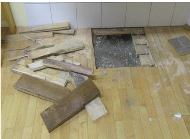
Ursache des muffigen Geruchs in einer Schule: Mit Holzschutzmitteln behandelte Polsterhölzer im Fußbodenaufbau.
