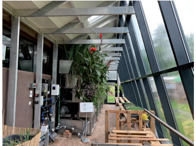
Gewächshaus mit Kläranlage
