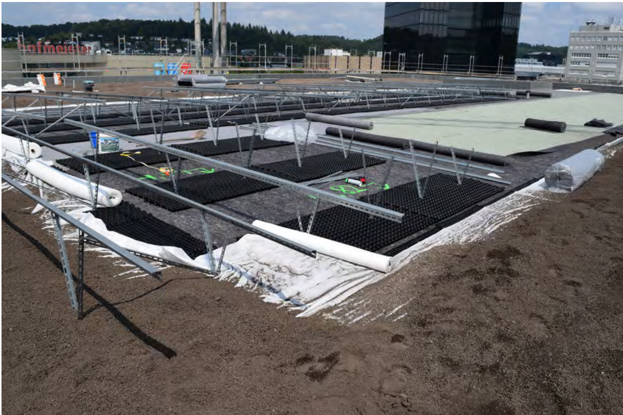
Abb. 51: Der Großteil der Dachbegrünungen, unabhängig ob extensiv oder intensiv, werden mehrschichtig gebaut. Quelle: BuGG
